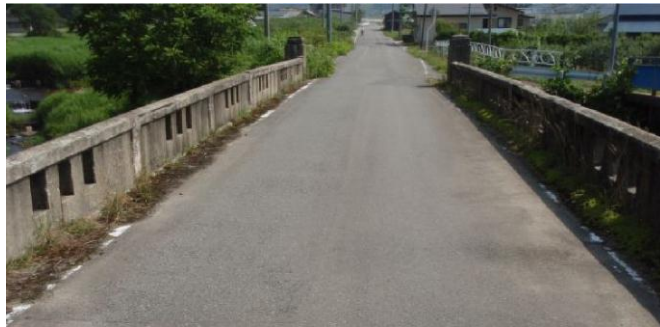
写真 5-1 コンクリート製防護柵
