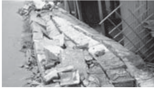
倒壊したブロック塀
