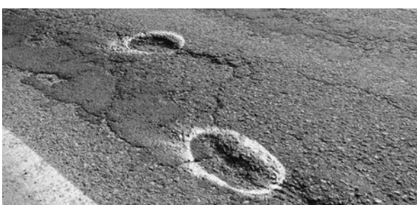
破損した道路
