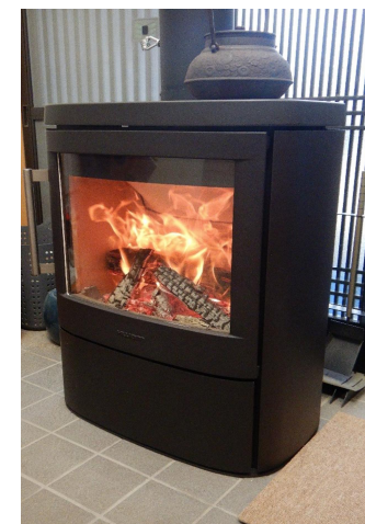
薪ストーブの設置状況
